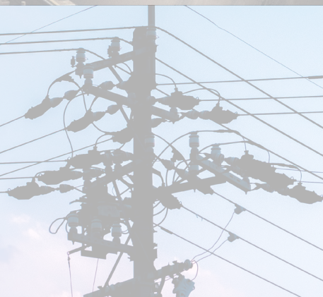
Cables Aéreos Aislados
